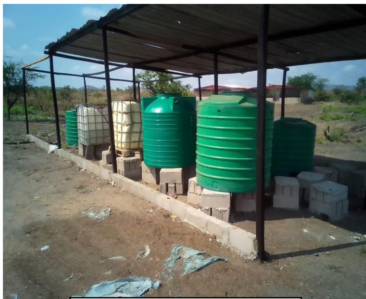
Tanque para armazenamento de água.
