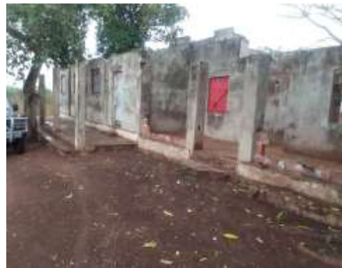
Foto 3: Infraestruturas por melhorar
