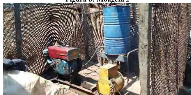
Figura 10: Gerador Diesel 16 HP
