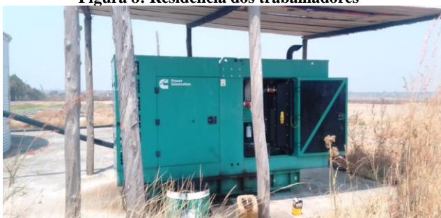
Figura 10: Gerador da fazenda de 155 KVA
