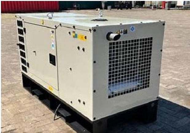
Figura 26: Gerador PERKINS 22 Kva
