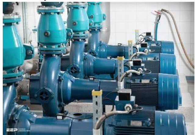
Figura 29: Sistema de bombagem de água filtrada em contentor de 40 pés
