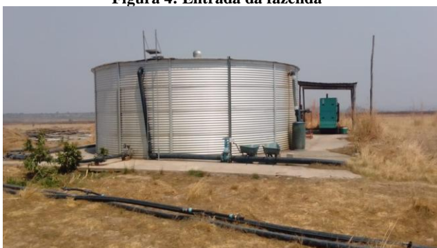
Figura 6: Tangue reservatório de água de 270 m 3
