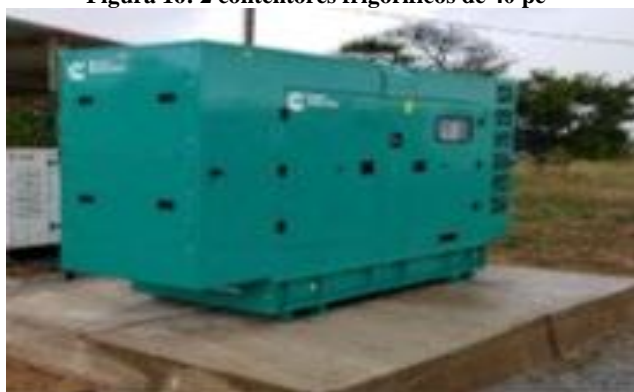
Figura 18: Gerador Cummis C170d5-155KVA
