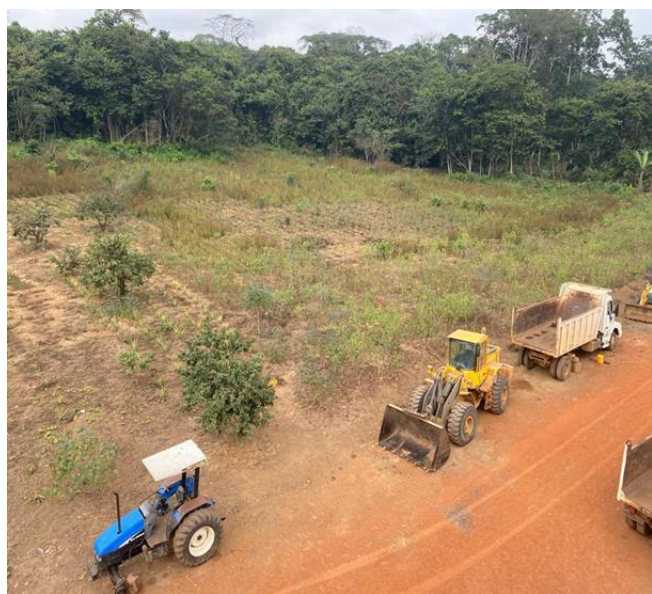
Foto 4: Parque de Maquinas
