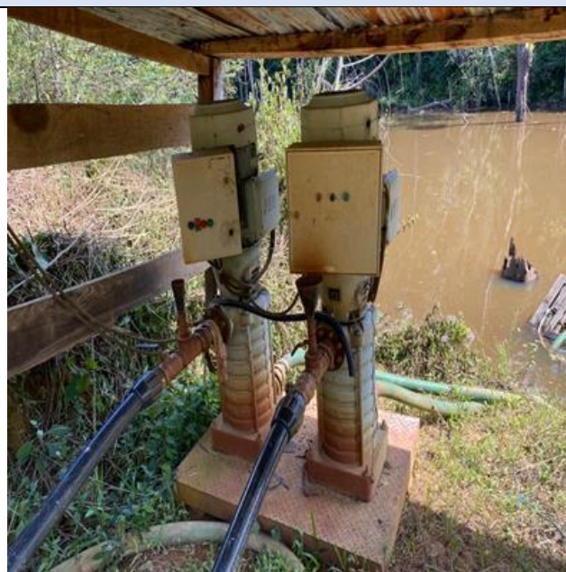
Foto 8: Bombas de 8 Polegadas
