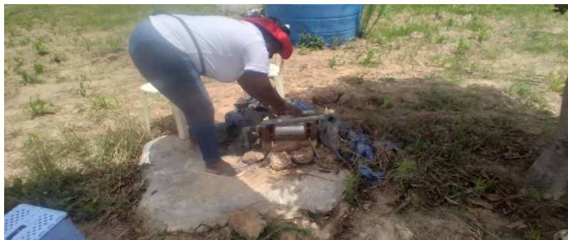
Figura 6: Furo de água
