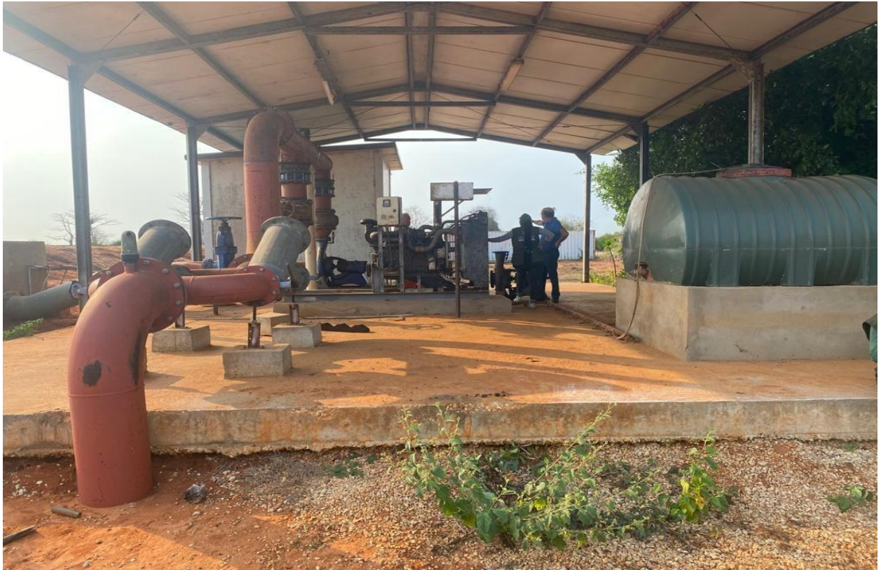
Figura 23: Central de Bombagem d'água para os Pivôs
