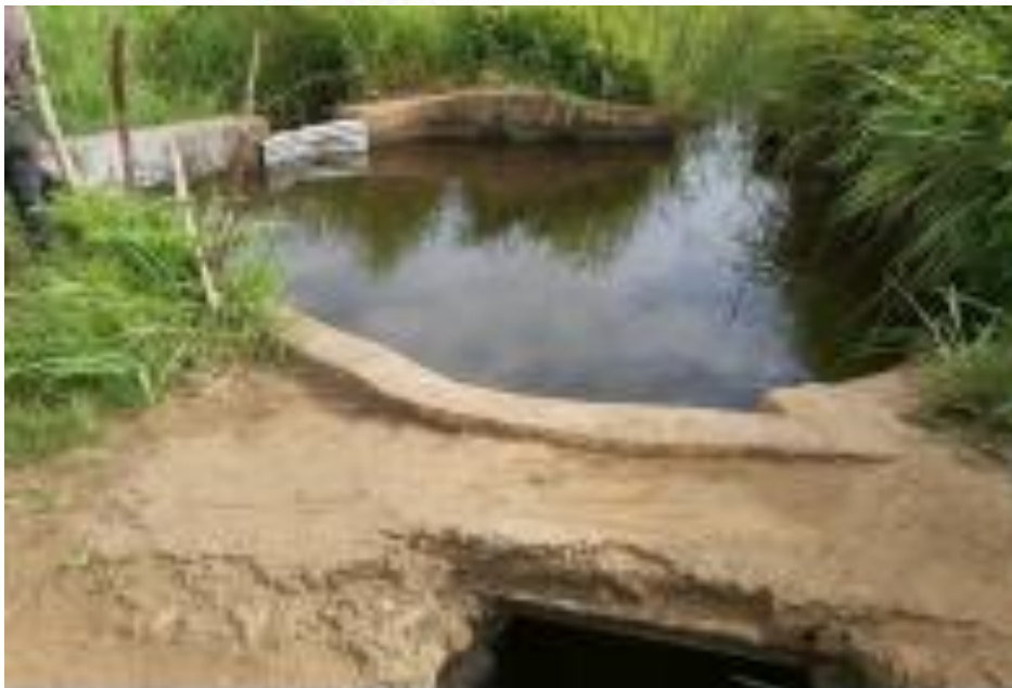
Bacia de distribuição
