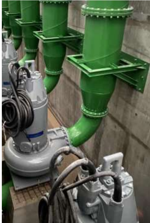
Figura 10 – Fotografias de instalação com grupos electrobomba submersíveis, tipo drenagem
